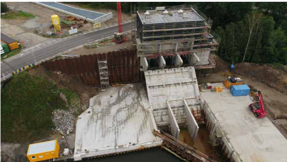
↓ Pompinstallatie met waterkrachtcentrale op het sluiscomplex te Diepenbeek (ill. De Waterweg)
