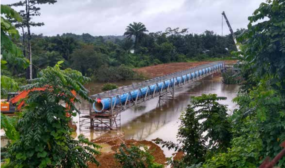
↑ Via Design & Build gerealiseerde ruwwaterleiding in Liberia (ill. Denys)
