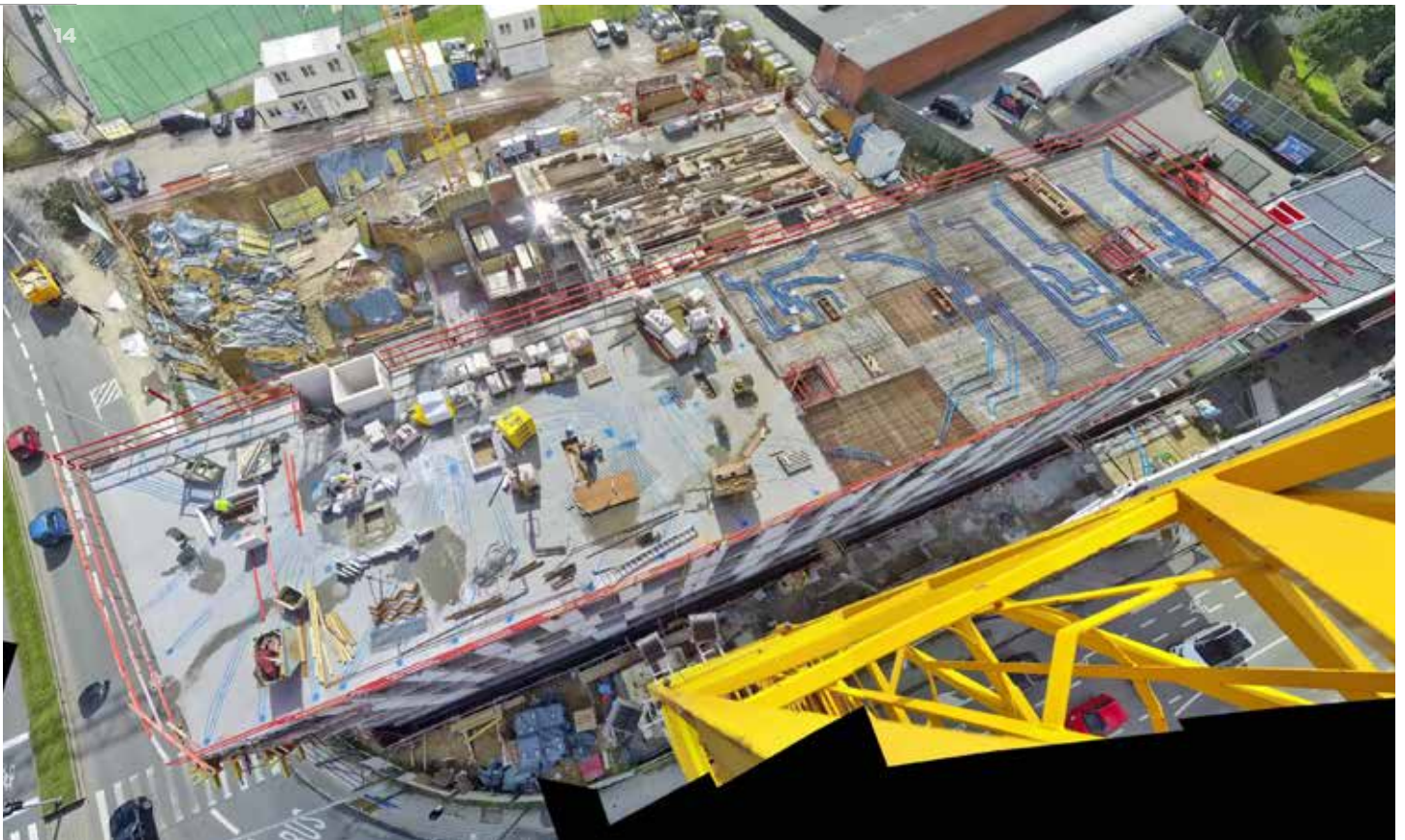
↑ Bouwplaats voor het woon- en winkelcomplex O'Building in Evere (ill. VDS Vanderstraeten)
